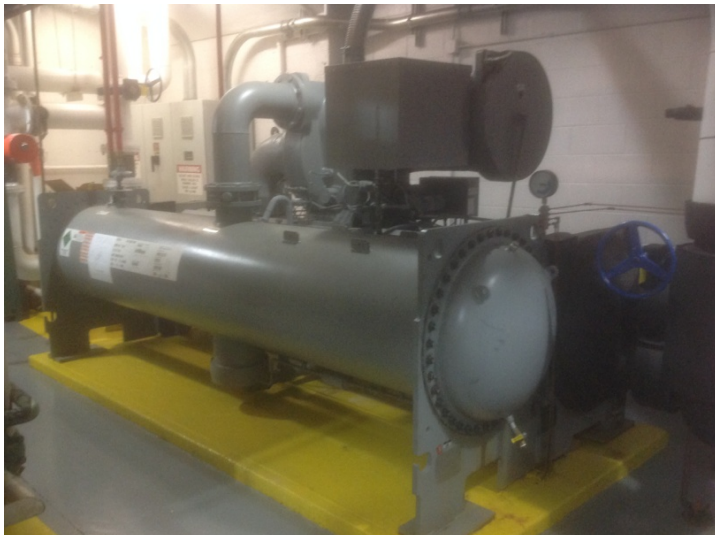
M.2 430 ton chiller
