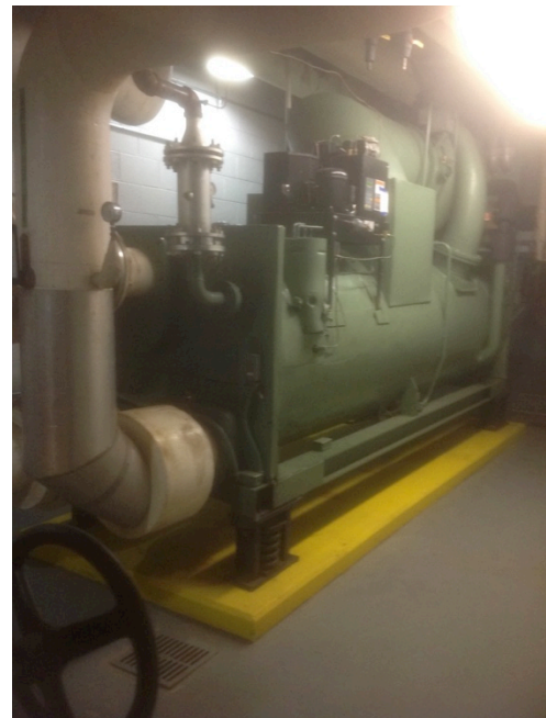
M.3 300 ton chiller
