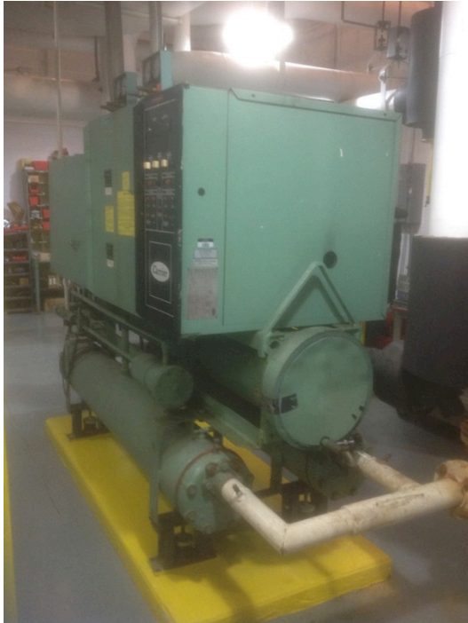
M.4 60 ton chiller
