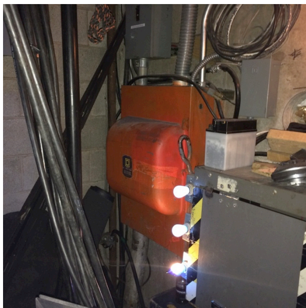
E.9 400A Show Power (Auditorium)
