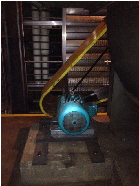
M.15 Bowl AHU Supply Fan
